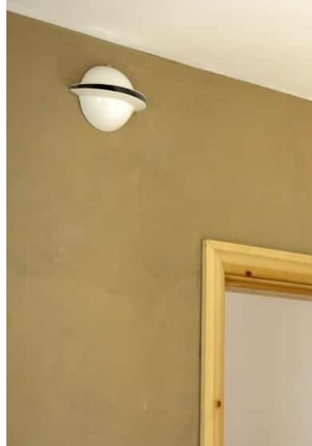
Air supply grille (bedroom)
